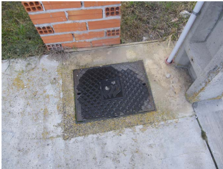
Imagen de acometida de arqueta electricidad en el entronque entre la calle de la Cabrera y el vial propuesto
