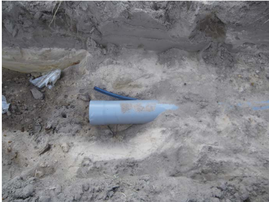
Imagen de acometida de abastecimiento de agua y saneamiento existentes a pie de la Parcela 68 del Polígono 4
